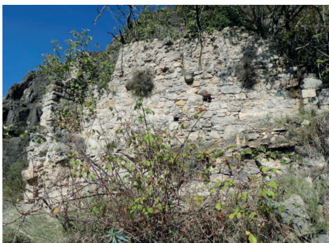
Muro norte de la casa del Señor, junto al espolón rocoso, al sur del mismo. Se trata de un muro antiguo, con buena argamasa de cal.
