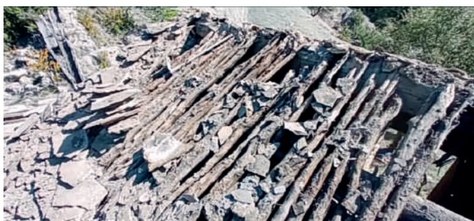
El tejado del molino de La Cabezónada, antes de actuar.
