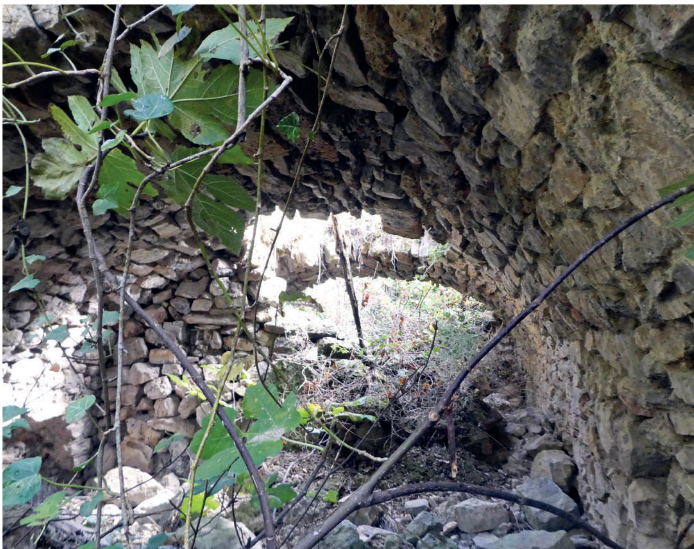
Bóveda en la casa del Señor, parcialmente hundida.
