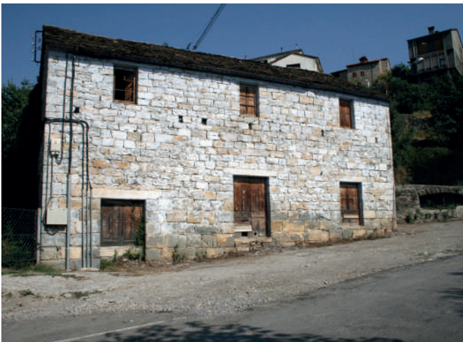
El torno de Boltaña antes de su rehabilitación.
