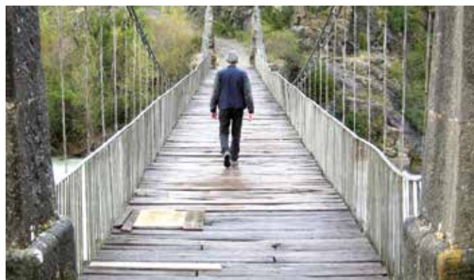
El tablero del puente de Jánovas; las tablas se van deteriorando.
