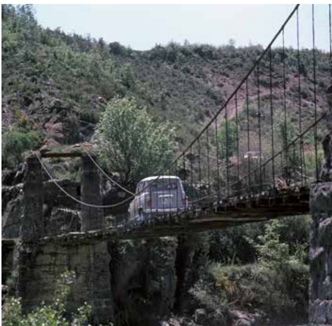
La pasarela de Lacort en 1978. Hoy está prohibida la circulación por el deterioro en el tablero.
