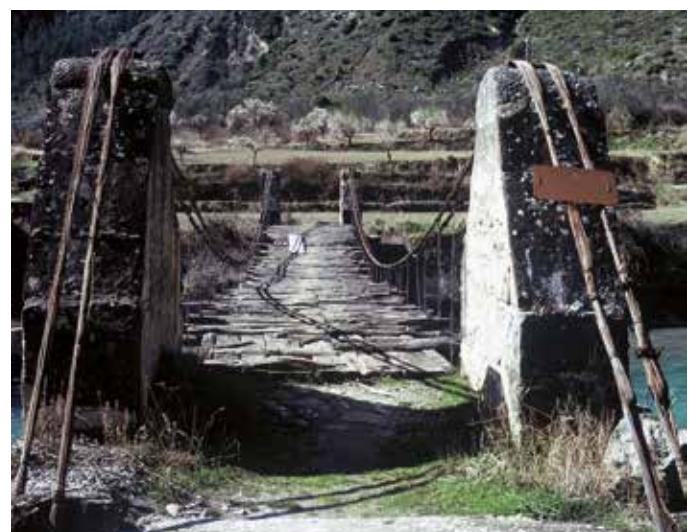
La pasarela de Santaliestra sobre el río Esera, en muy malas condiciones de conservación.
