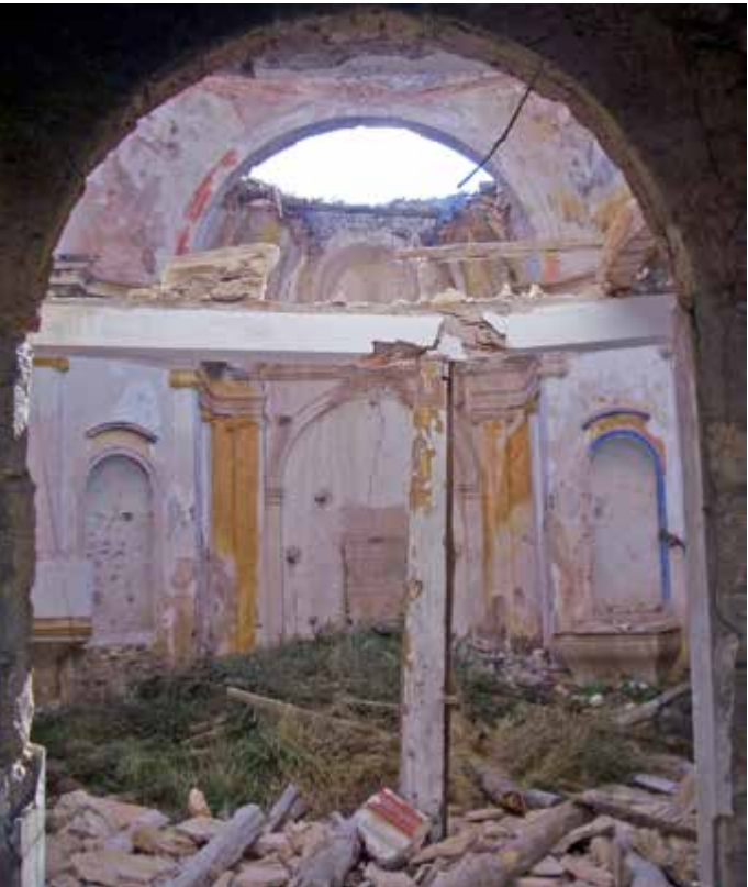
Actualmente, el interior de la iglesia presenta un estado lamentable
