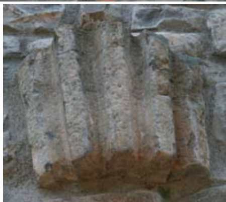
Rejola en el casco de la bóveda central. Fragmento de nervadura reaprovechado en una fachada
